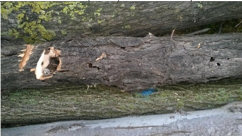
Branques corcades i podrides que comporten perill, visibles prèvia retirada
